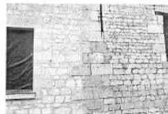
Transition dans la façade entre un mur ravalé, rejointoyé et l'ancien mur.
